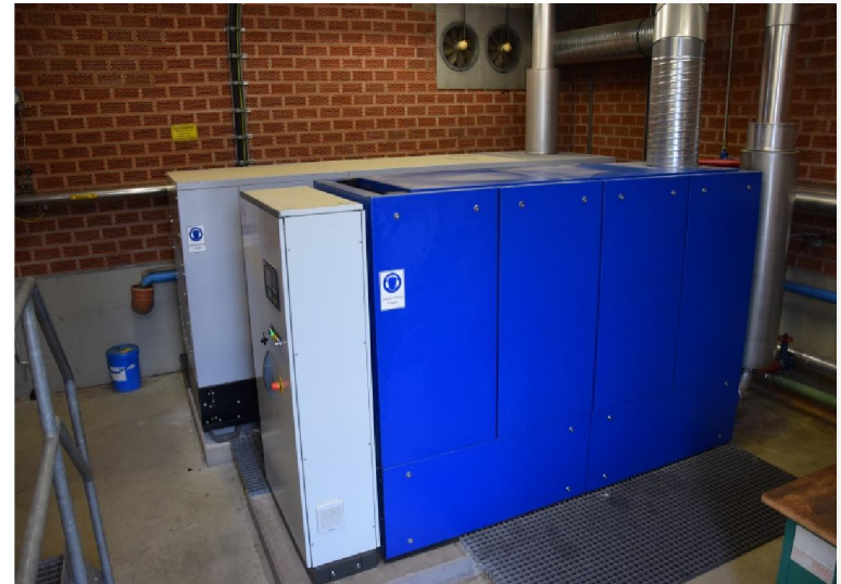
Blockheizkraftwerk (BHKW) el. Leistung 65 kW/h 2 Notstromaggregate el. Leistung 230kW/h
